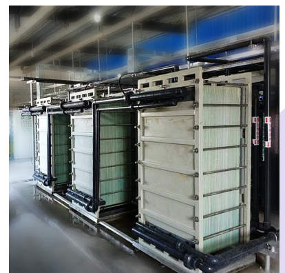
EDR大型濾鹽設備 5000噸/日
