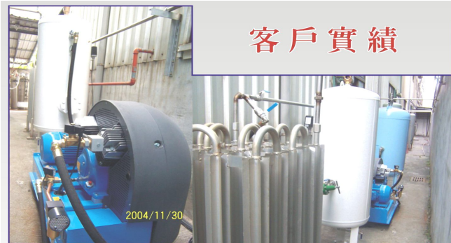
圖 10. 氮氣高壓增壓系統
